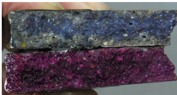
Abbildung 4.7: Bestimmung der Carbonatisierungstiefe mithilfe der Indikatoren Thymolphthalein (oben) und Phenolphthalein (unten) an Probe R045(1-3)c. Die Probendicke beträgt ca. 10 mm.
