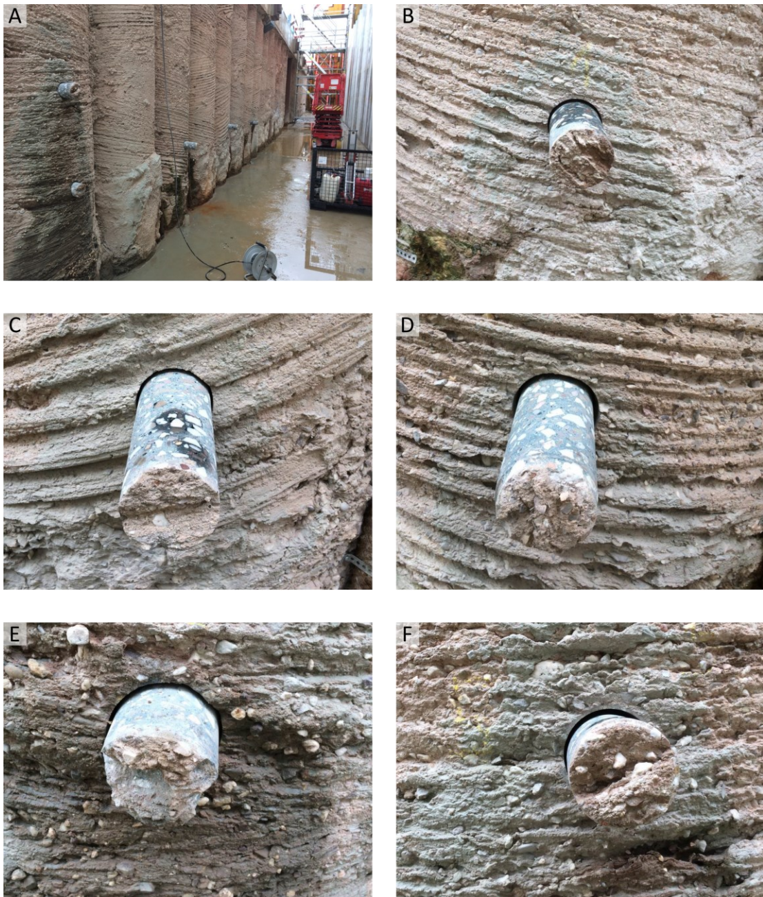
Abbildung A 5.1: Bohrkerne aus Bohrpfahlwand der Baumaßnahme zweite Schleuse Trier: A) Übersicht über Lage der Bohrkerne, B) Bohrkerne 1, C) Bohrkerne 2, D) Bohrkerne 3, E) Bohrkerne 4, F) Bohrkerne 5
