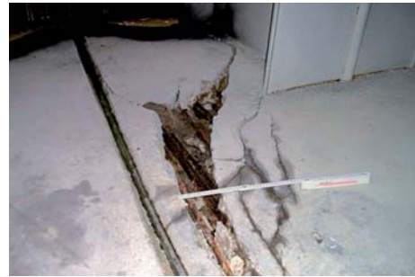
Bild 2.10: Schädigung im Bereich einer Dehnfuge am Containerterminal CT3 in Bremerhaven (aus Morgen, 2008)
