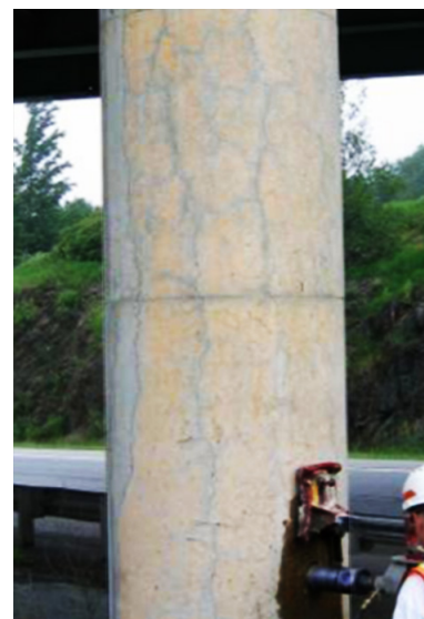
Abbildung 2.2: Vertikale Risse an einer Stahlbetonsäule aus [2].
