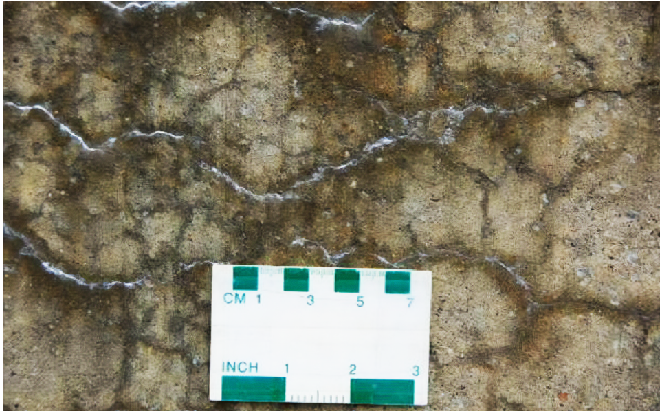
Abbildung 2.3: Verfärbungen am Rissmuster aus [2].
