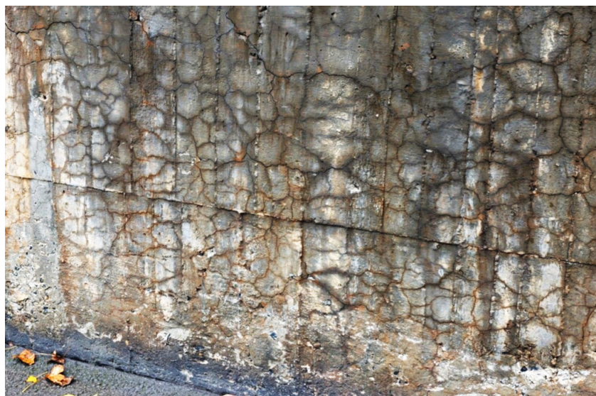
Abbildung 2.1: Ein klassischer AKR Schaden, Map Cracking an einer Unterführung in Cottbus aus [29].
