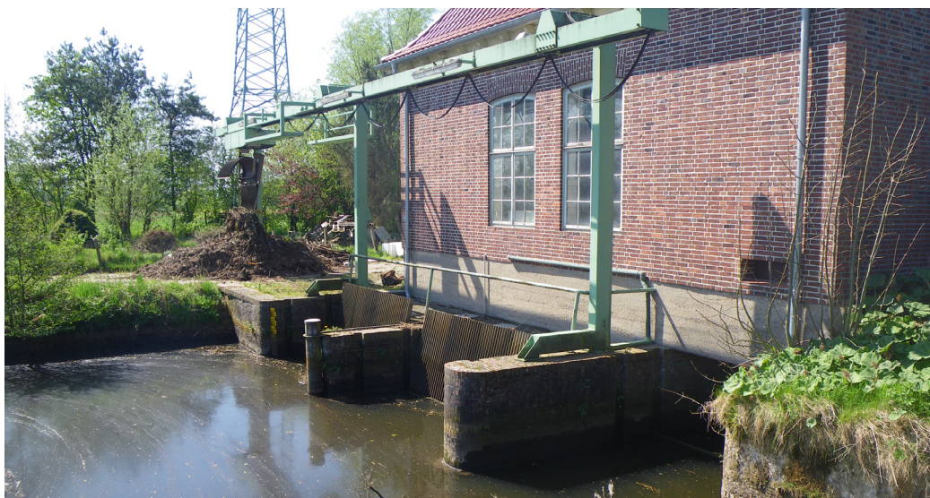
Abbildung 40: Schöpfwerk an der Este
