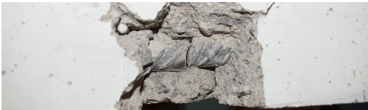
Bild 4.7-16: Bruch eines Bewehrungsstabes V6d
