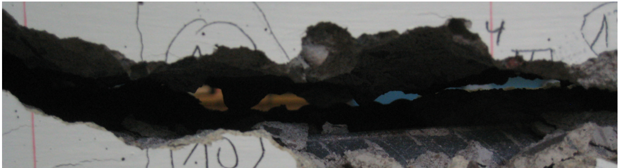
Bild 4.7-21: Ablösen der Längsbewehrung von der Betonmatrix (V7b)
