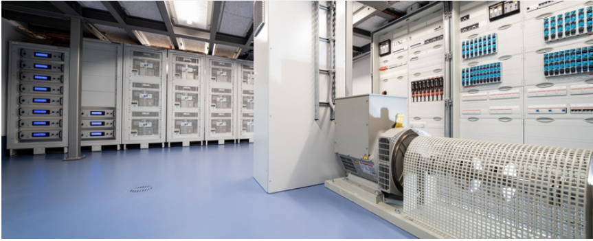
Abb. 8: Power hardware-in-the-Loop Netzlabor (NESTEC) des DLR-VE
