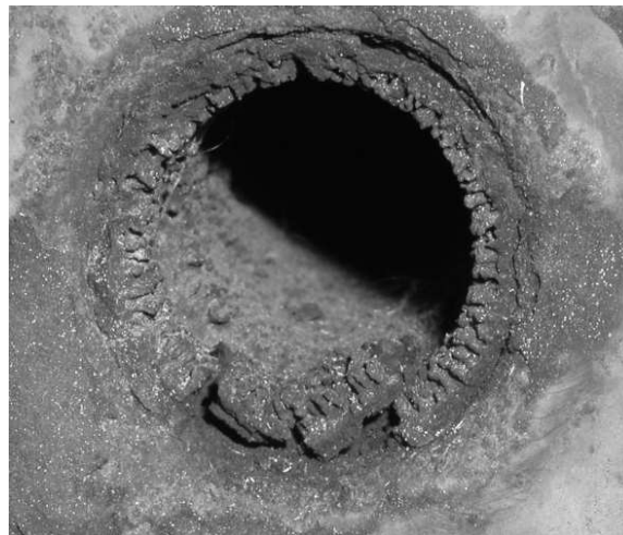
Abbildung 5.3: Teerablagerungen auf der Rohgasseite eines Wärmetauschers
