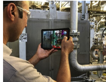
(b) Sichtprüfung von Rohrverbindungen einer Anlage mithilfe überlagerter CAD-Modelle [262].
