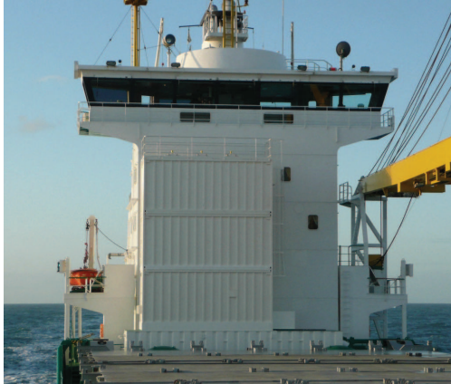
Abbildung 5.2. – Installierte Abgasentschwefelungsanlage in 20ft-Containern auf MS „Timbus“
