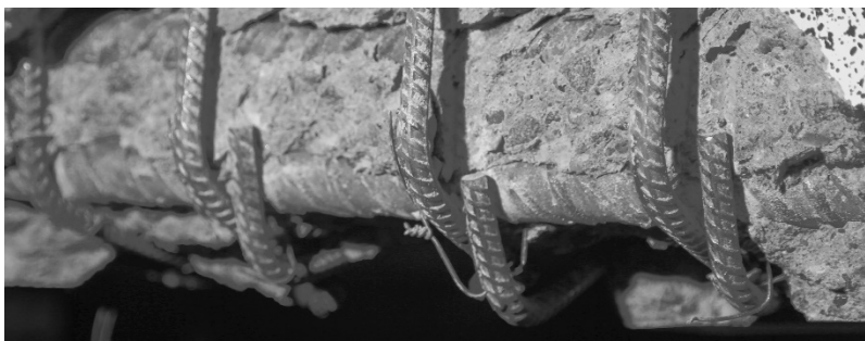
Bild 183 Ausbrechen der Übergreifung der Bügelbewehrung
