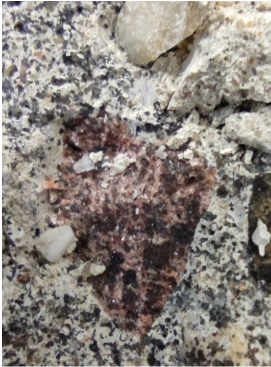
Bild 422 Bereich 3, nach Belastung
