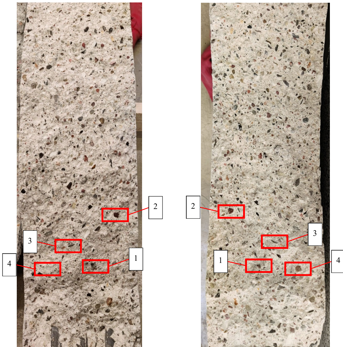
Bild 387 B2.2 Rissoberfläche Unterseite
