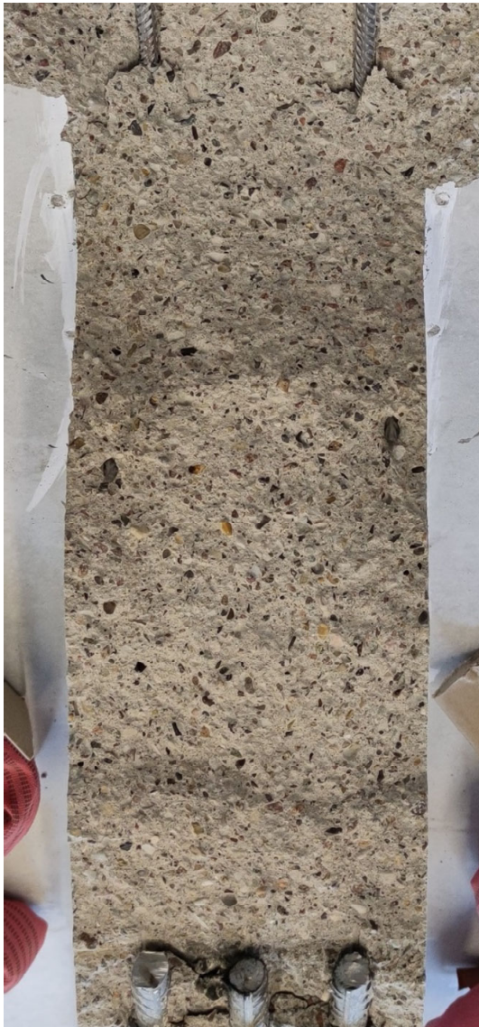
Bild 439 B7.2.2 obere Rissoberfläche
