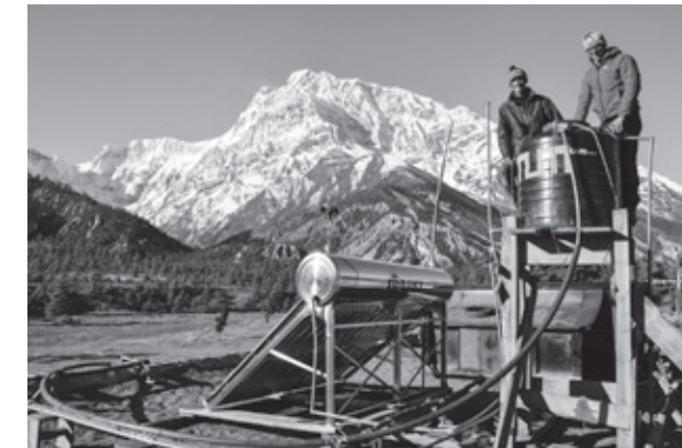
Abbildung 3 Projekt Warmwasseranlage an der Lophelling-Schule (Nepal)
