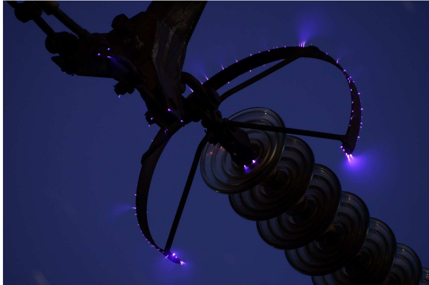
ABB. 3.7: Koronaentladung am Koronaring einer 500-kV-Freileitung ( Cor, 2013 )
