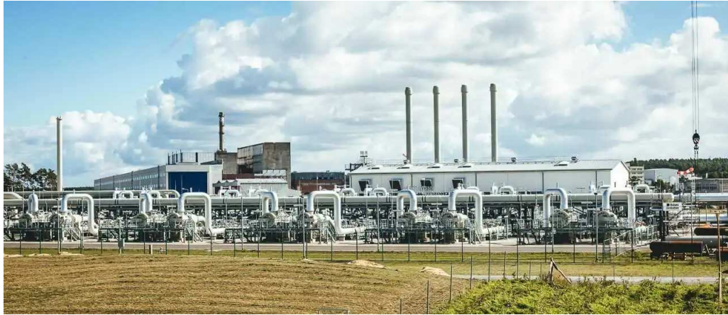
ABB. 3.12: Verdichterstation der North Stream Pipelines in Lubmin ( Joachim Schmidt, 2022 )
