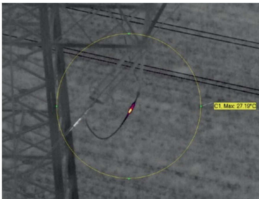
ABB. 3.6: Standbild einer Thermalkamera von einem technischen Leitungsdefekt, welcher zu einer Hitzequelle führt ( Schultze, 2020, S.716 )
