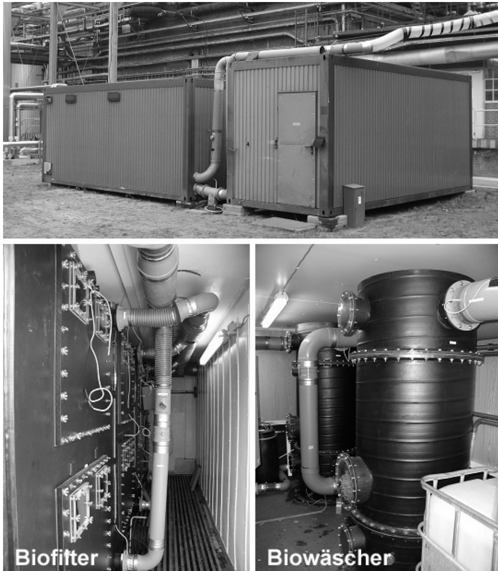
Abb. 16: Foto der Abluftbehandlungsanlage im halbtechnischen Maßstab (oben) mit Blick in den Biofilter- (links) und Biowäschercontainer (rechts)
