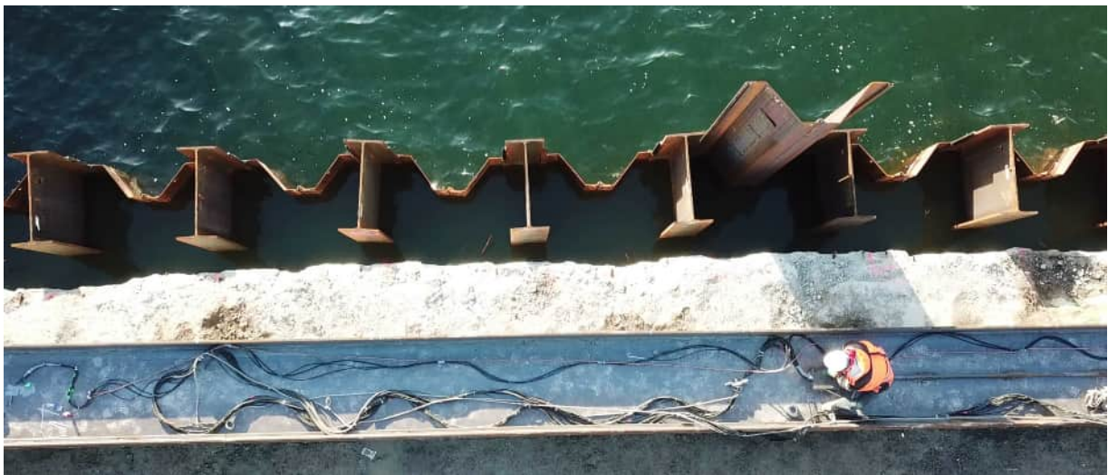
Abb. 2.1: Kombinierte Spundwand am Liegeplatz 23 in Rostock mit dem Träger HZ 1180MA und den Zwischenbohlen AZ 20-700. Foto: J. Beuße
