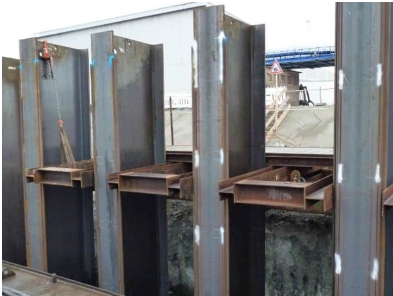
Abb. 2.3: Ausführung der Rammführung als Kammführung bei der Messung am Liegeplatz 23 in Rostock. Foto: Arge Neubau Liegeplatz 23 Seehafen Rostock
