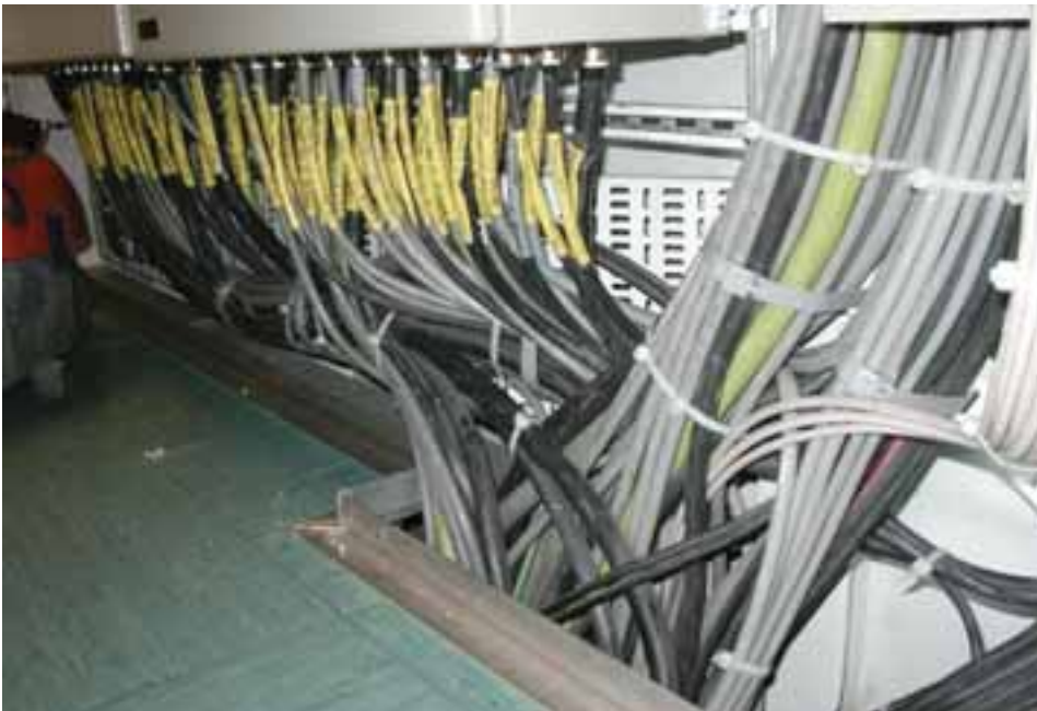
Kabelstränge im Brückenbereich
